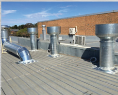
Exhaust fan and air return
